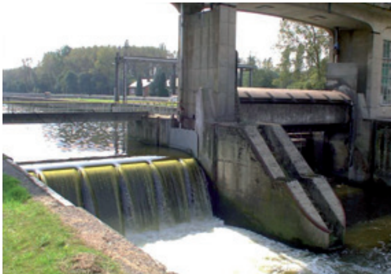
Figure 5. Vannes mobiles pour la régulation des canaux. A droite, la vanne a été sortie de l'eau pour une opération de maintenance.
